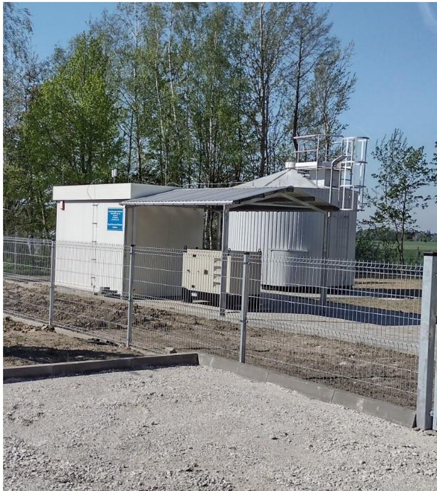
Fot. Stacja podnoszenia ciśnienia w Bielawie.
